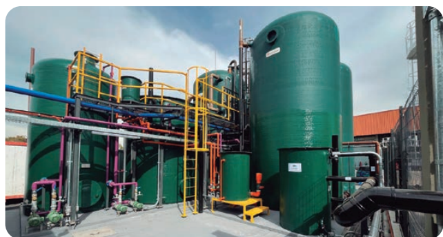
Estação Produtora de Água de Reúso (EPAR) do Expo Center Norte, que reduz o consumo de água potável por meio do tratamento e reúso da água
